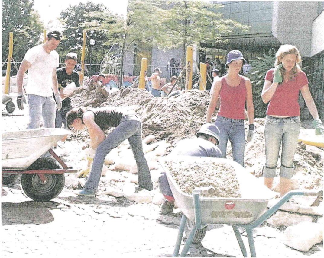
2005 begann die Neugestaltung des Schulhofs. Auch viele Schüler schwitzten bei der Arbeit.
