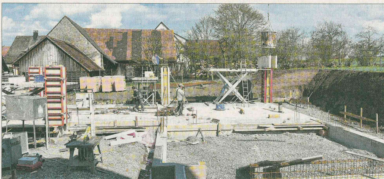
Die Bodenplatte für das Dorfgemeinschaftshaus musste 15 Zentimeter tiefer als geplant in die Erde gelegt werden. Stützpfeiler werden folgen. Unter der Keuperschicht war man unerwartet auf aufgefüllten Boden gestoßen.
